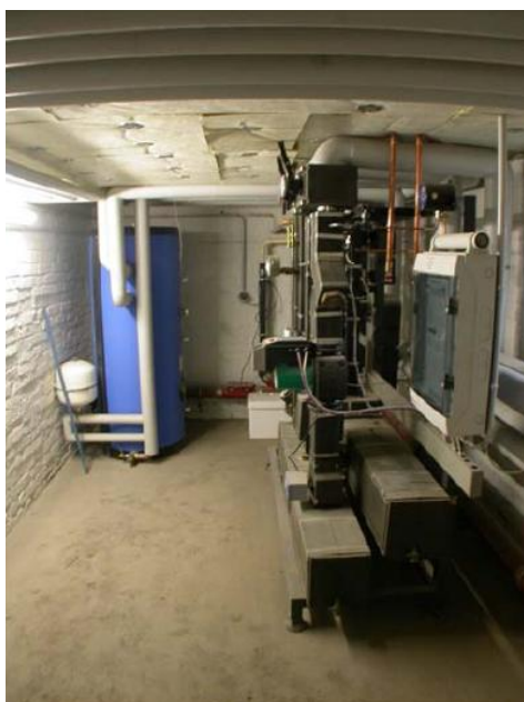
Foto 2: links Warmwasserspeicher, rechts Fernwärmeanschlussstation (Quelle: Parabel Energiesysteme GmbH)
