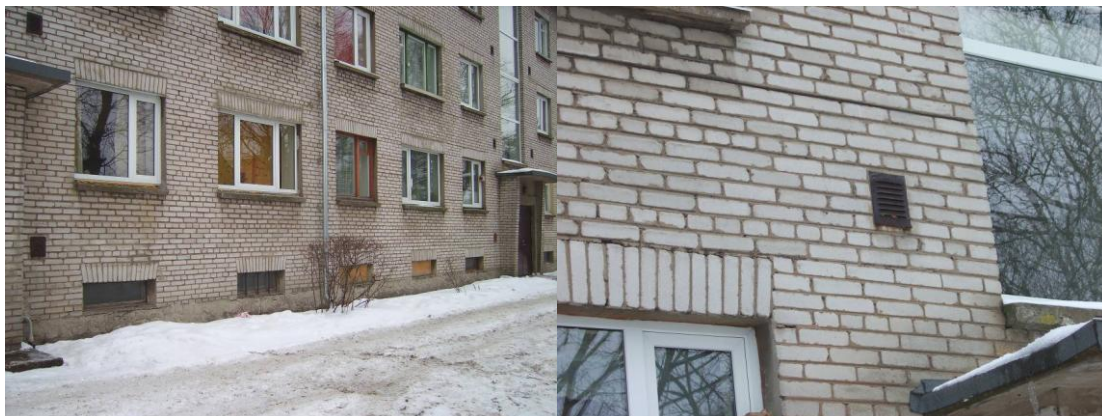
Elamus on gaaspliigid ja seetõttu ka omapärane ventilatsioonisüsteem. Ventilatsioonivad.
