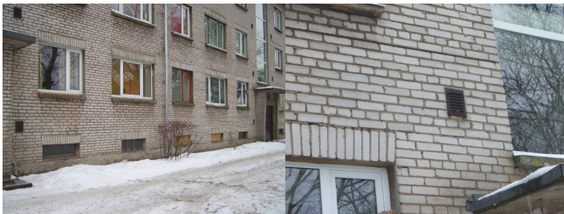
Elamus on gaaspliidid ja seetõttu ka omapärane ventilatsioonisüsteem. Ventilatsiooniavad.
