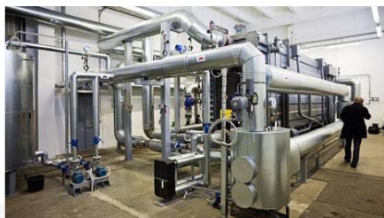
26.att., Absorbcijas siltumsūkņis koģenerācijas stacijā “Imanta” Rīgā
