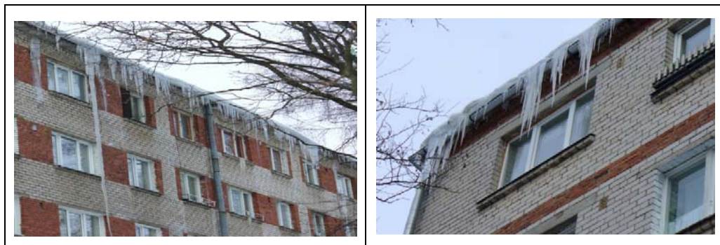
Attēls 7.1. 316./318. sērijas daudzdzīvokļu ēku vizuāli novērotais tehniskais stāvoklis 2010.g. februārī.
