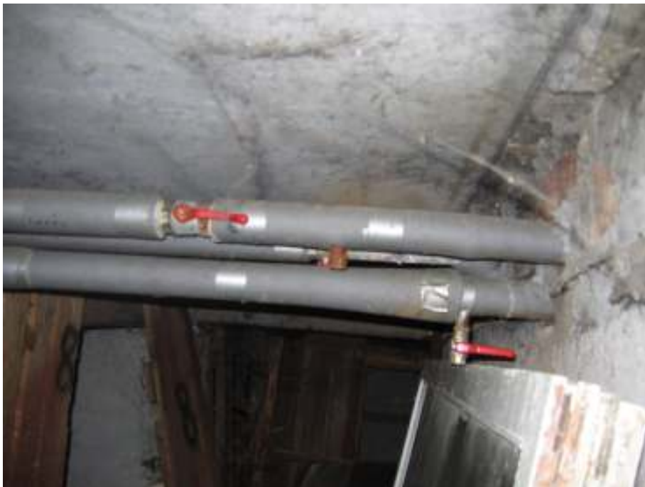
Attēls 14. Ūdensvada izolētas caurules pagrabstāva līmeni
